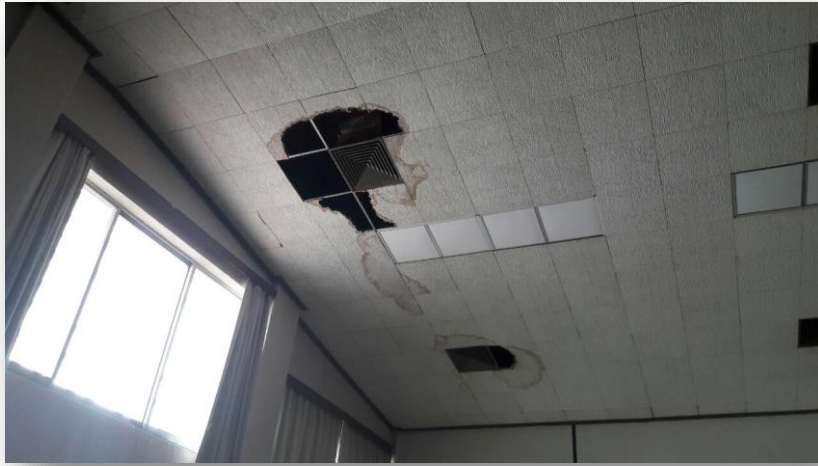
Εικόνα 7 : Πλάκες με φθορές στη διακοσμητική ψευδοροφή στο αμφιθέατρο ΒΑ
